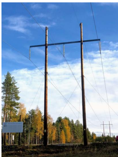
Figur 6. Exempel på en 170 kV luftledning i trästolpar med topplina.
