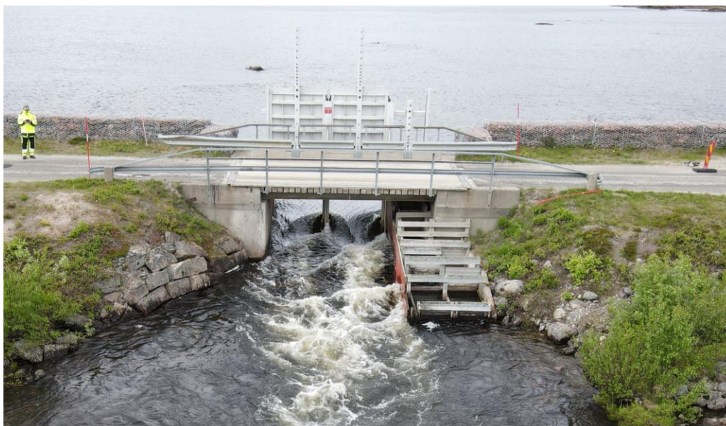
Figur 8. Teknisk fiskväg konstruerad i trä på nedströmssidan av utskov tre.
