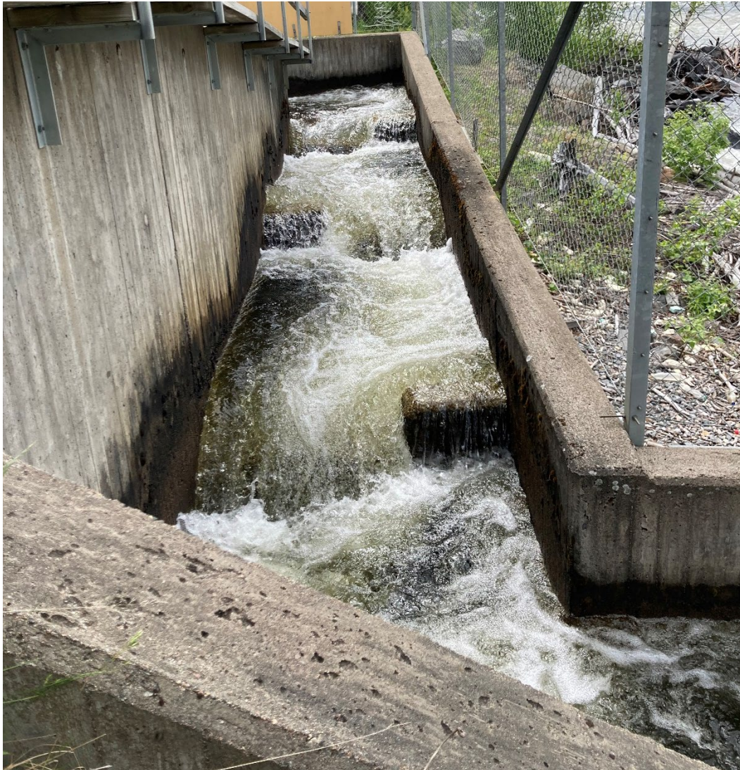
Figur 7. Foto som visar del av fiskvägen för uppströmspassage vid Sikfors kraftverk.
