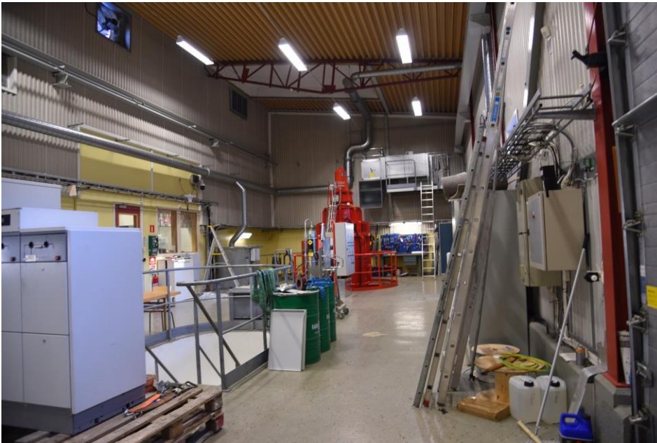
Figur 15. Foto på interiör i Hednäs kraftverk.
