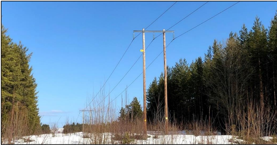
Figur 3-1. Exempel på en 36 kV-luftledning.
