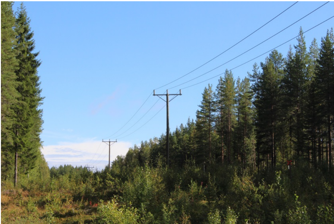
Figur 4–2. Befintlig kraftledning som i enlighet med koncessionsansökan avses kvarstå i befintlig utförande.
