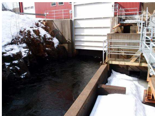
Figur 5. Hednäs kraftverk fisktrappa och kraftverkets utlopp.
