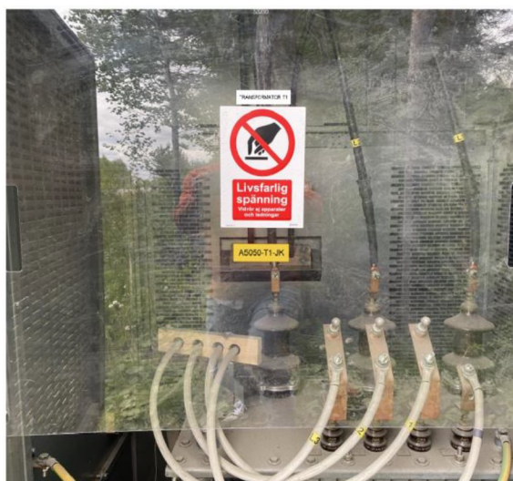
(Transformatorutrymme med plexiglas)
