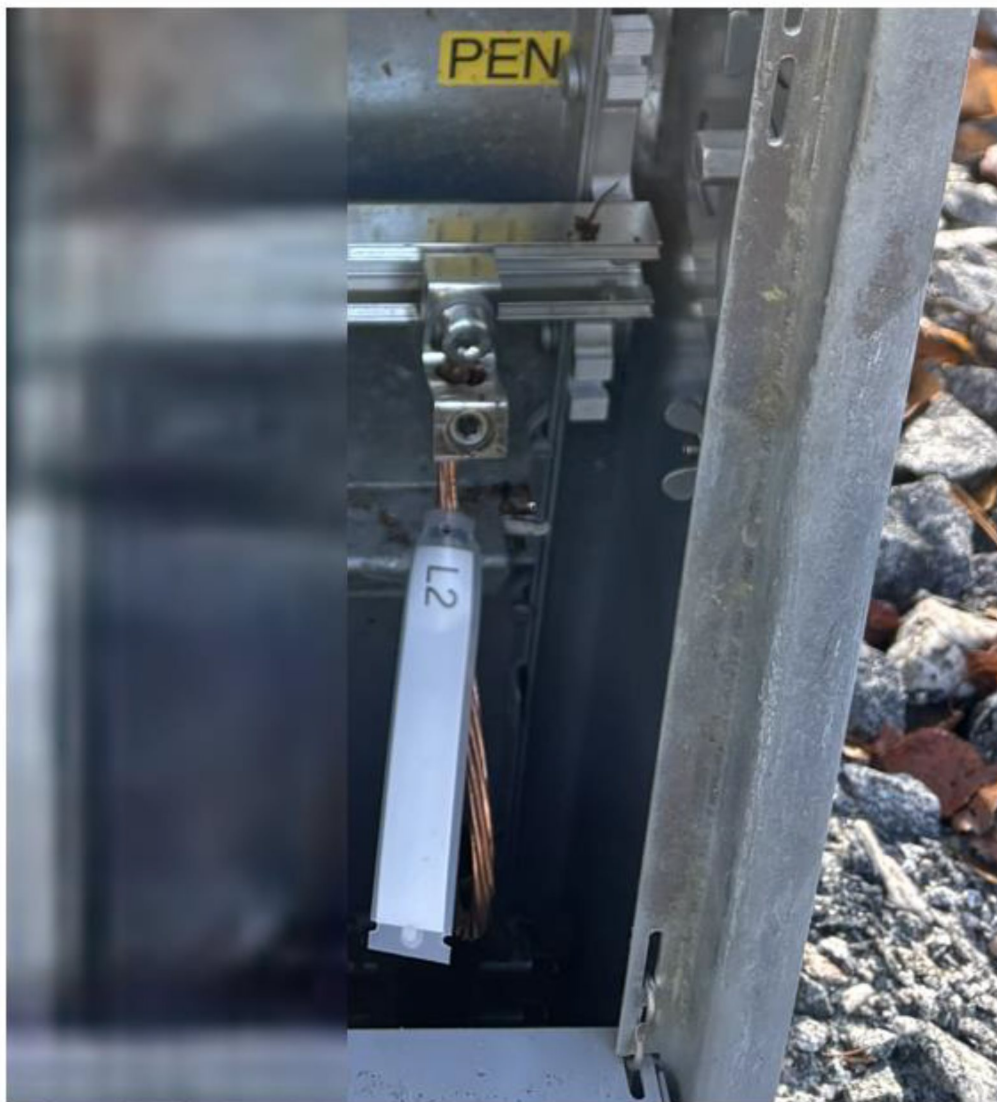
(Märkning av jordtag isolertransformator (mark/stolpe), kabelskåp sekundärsida, L2)
