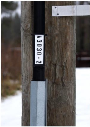
(Kabel går till nätstation (mark), HSP-fack 2)
