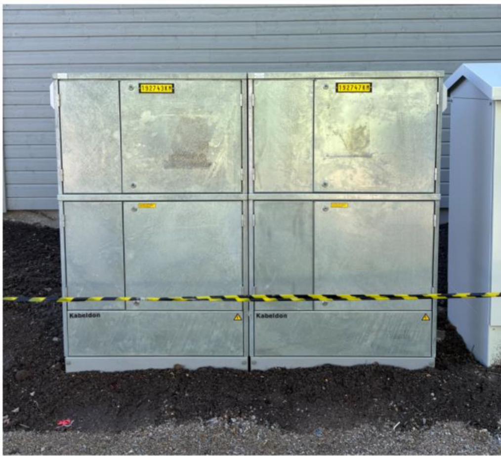
(Yttre märkning av kabelmätarskåp KM – två kabelmätarskåp bredvid varandra)
