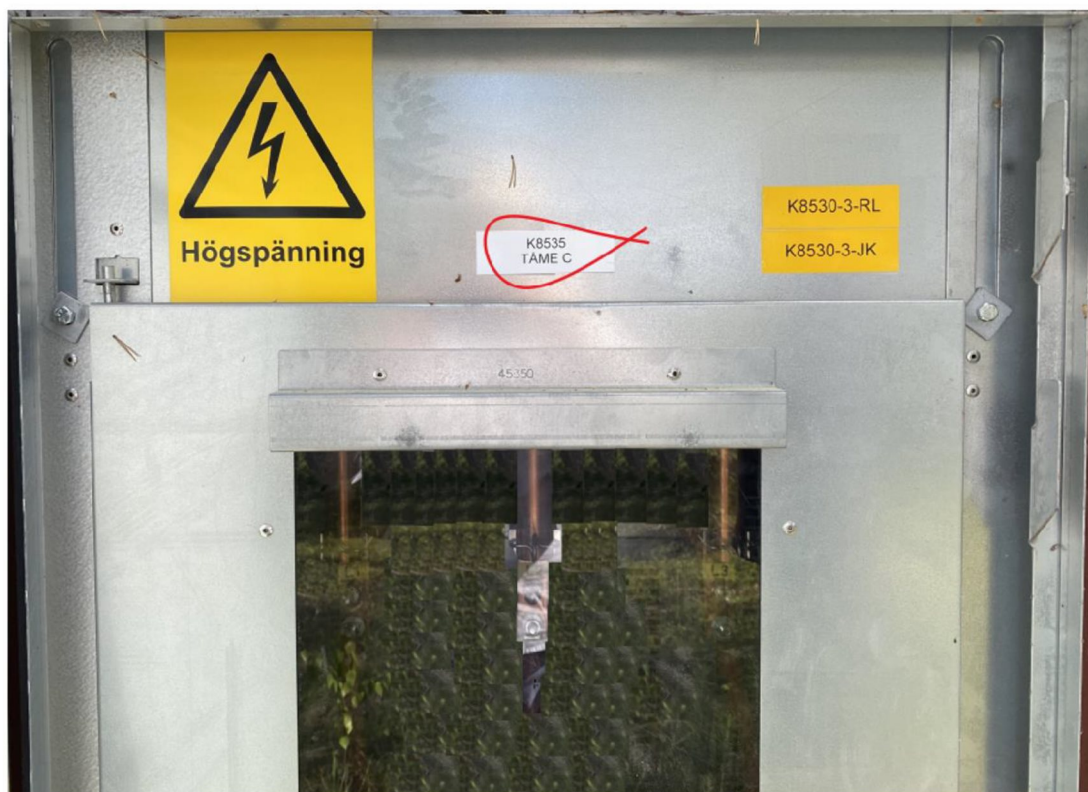
(NAB, adressmärkning på fast del i högspänningsfack med dörr)
