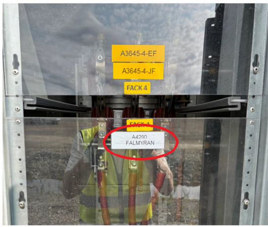
(NAB, adressmärkning i högspänningsfack på nedre plexiglas)
