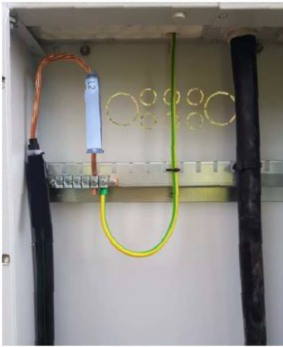
(Märkning av jordtag i Ensto markmätarskåp - kundanläggning, L2)
