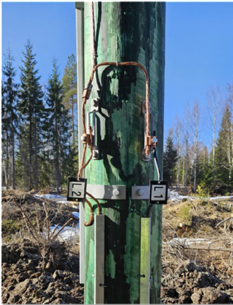
(Märkning av två jordtag i luftledningsstolpe, L1 och L2)
