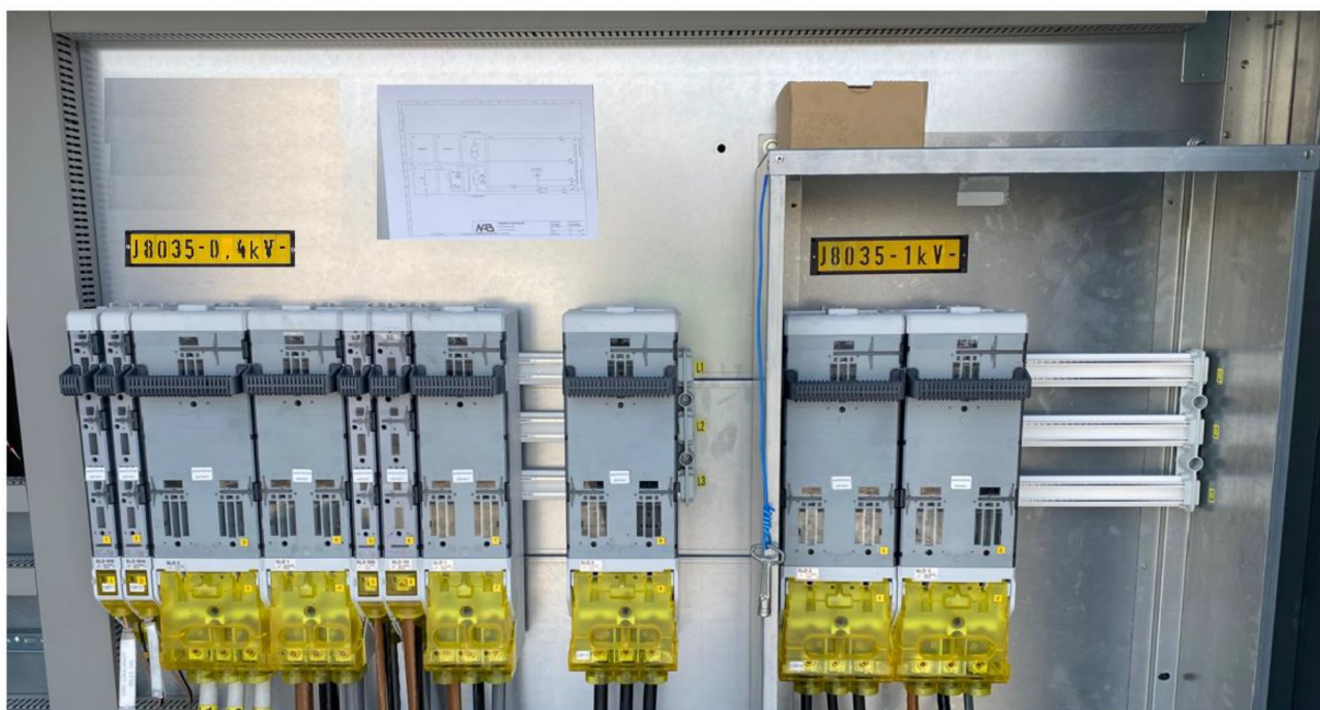
(Lågspänningssida i nätstation (mark) med lågspännings-ID för 0,4 kV och 1 kV skena)
