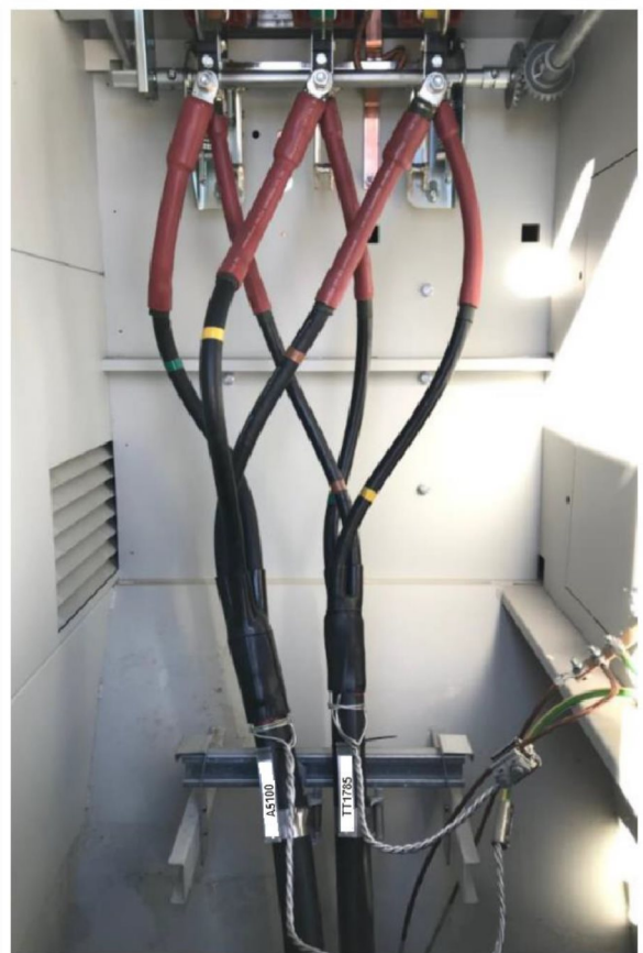
(Adressmärkning (DYMO) buntade på kablar)
