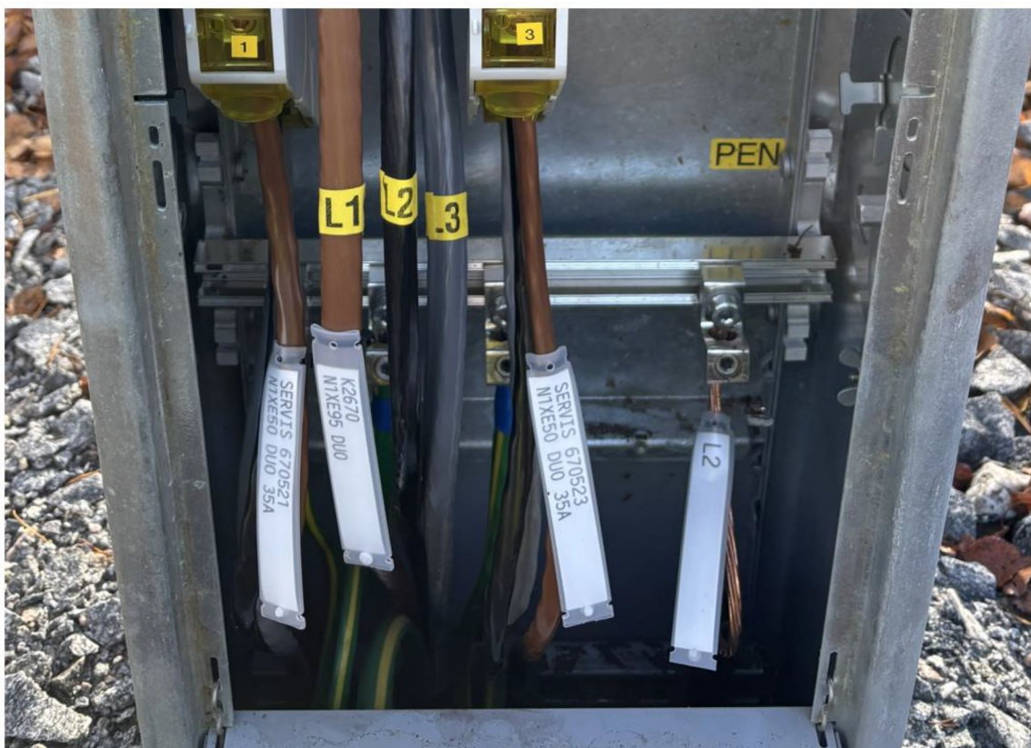
(Märkning av jordtag i kabelskåp K, L2)
