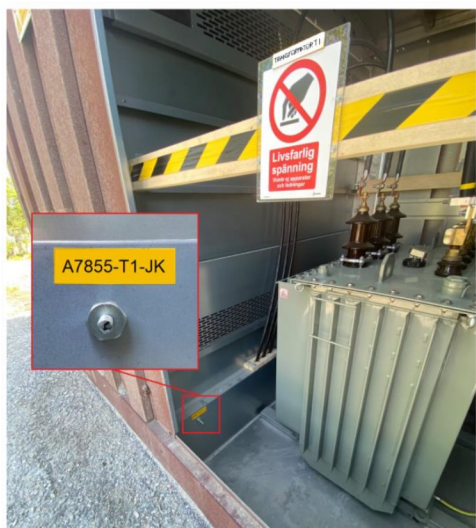
(Transformatorutrymme med träregel)
